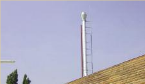
Bild 1: Metallschornstein mit getrennt, isolierter Fangeinrichtung.
