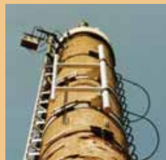
Bild 6: Funkantennen am Schornsteinkopf.
